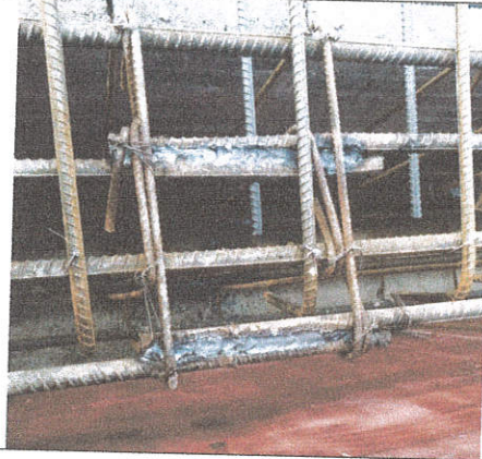
地梁钢筋有一处焊接后焊渣未清除已整改
