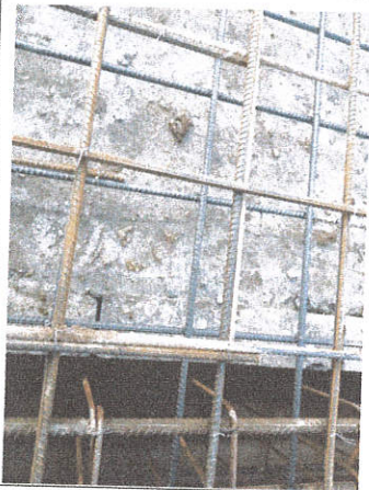
有一处底板钢筋漏扎已整改
