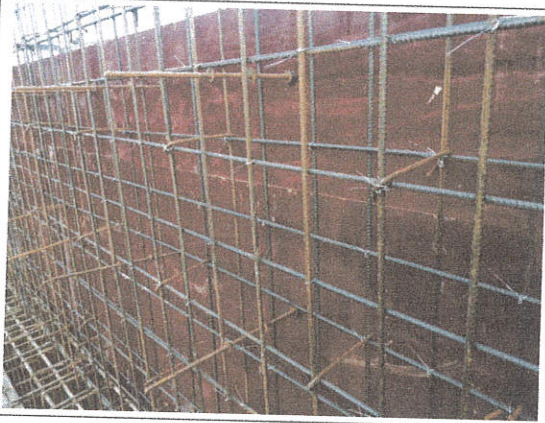
墙板局部缺少混凝土垫块已整改
